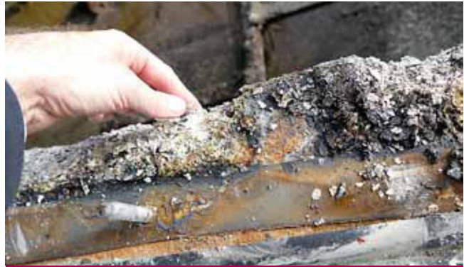
Foto 5.2: Von Hand lassen sich Materialproben aus der beschädigten Fermenterwand entnehmen.
