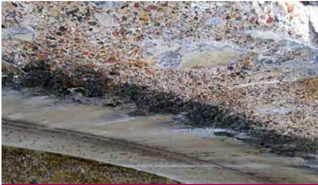
Foto 5.1: Hier ist der Materialabtrag an der Behälterwand sehr gut erkennbar.
