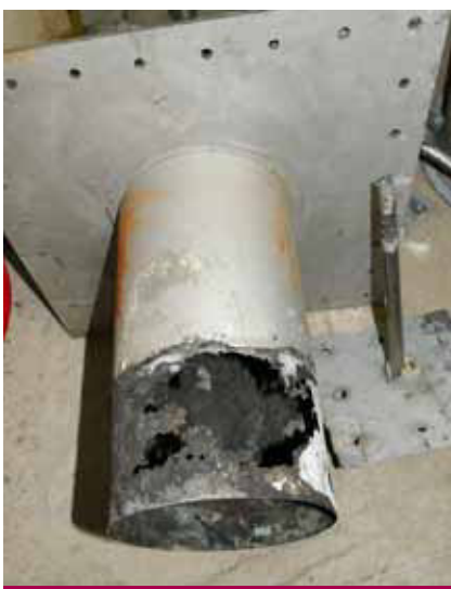
Foto 6.1: Vorn beschädigtes Edelstahlrohr, das in den Gasraum hineinragt.
